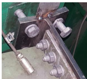
Фигура 5.13 - Съединение след разрушение: фланцеви T-профил
