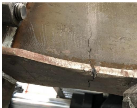
г) Разрушение в средата на RBS 1C
